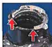
POŠKODOVAN pritrditveni obroček
